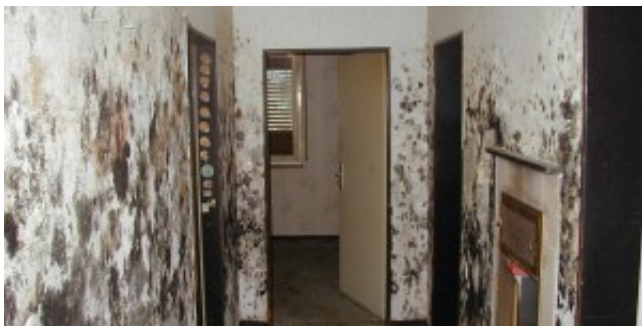
Schimmelschaden in einer Wohnung
